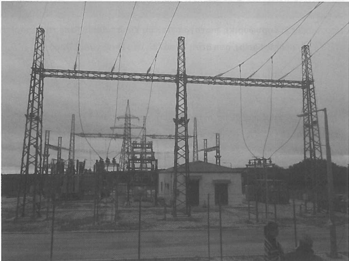
Φωτογραφία 1: Αποψη του Υποσταθμού 20/150kV και των γραμμών μεταφοράς ηλεκτρικής ενέργειας υψηλής τάσης (150kV) στη θέση “Μπάλα”, στο Παναχαϊκό Όρος, στο Δήμο Πατρέων του Νομού Αχαΐας.
